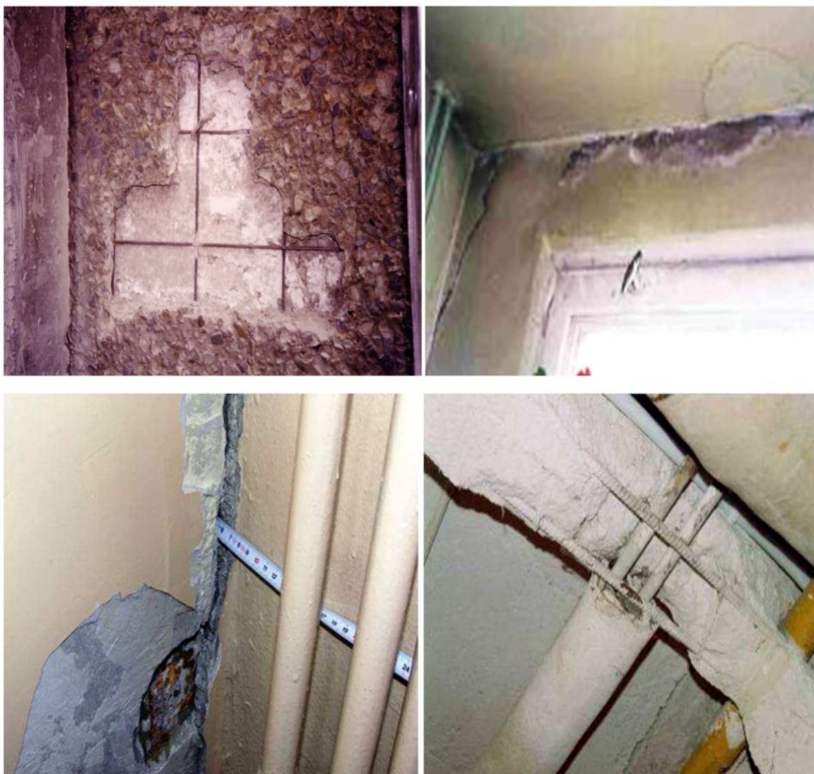
Rys. 34. Przykładowe uszkodzenia budynku przedstawione w pracy [95].
