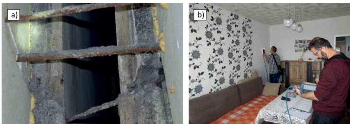
Rys. 29. (a) Pręty montażowe pozostawione z czasów budowy budynku prefabrykowanego, (b) Pomiar georadarem przestrzeni dylatacyjnej pomiędzy przegrodami pionowymi w budynku prefabrykowanym [61].
